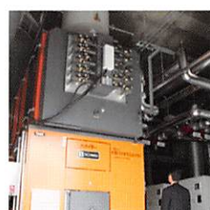
木質バイオマスボイラー
